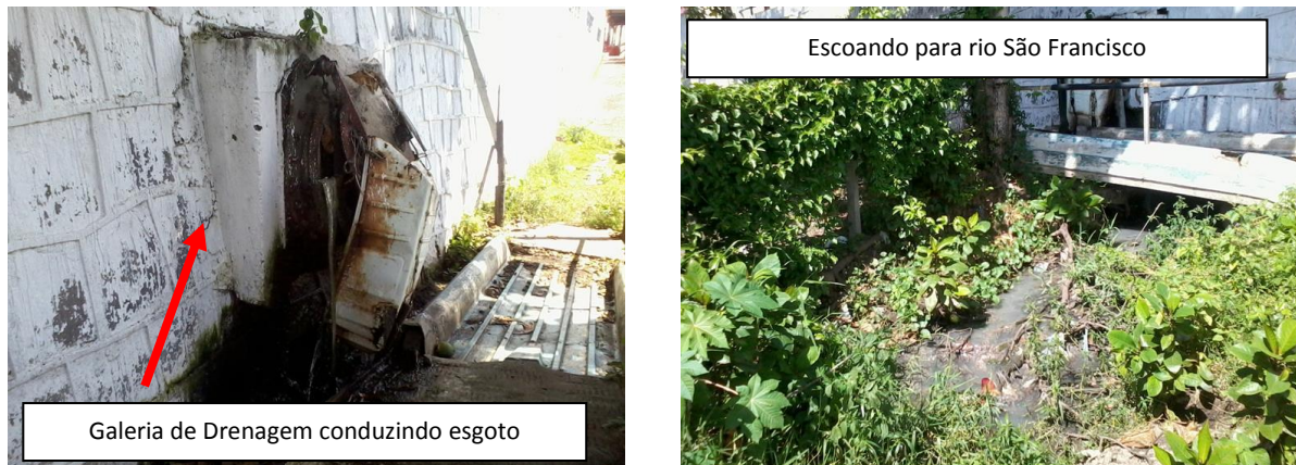
Figura 9: Lançamento de esgoto inadequado na sede municipal de Propriá. Fonte: Gesois, 2014.
