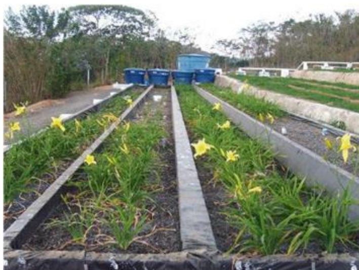
Figura 24: Tratamento de esgoto sanitário em sistemas alagados construídos cultivados com lírio amarelo Fonte: Costa et al., 2003
