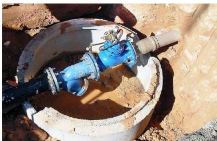
Figura 13: Equipamento para combate às perdas Fonte: Viegas et al., 2006
