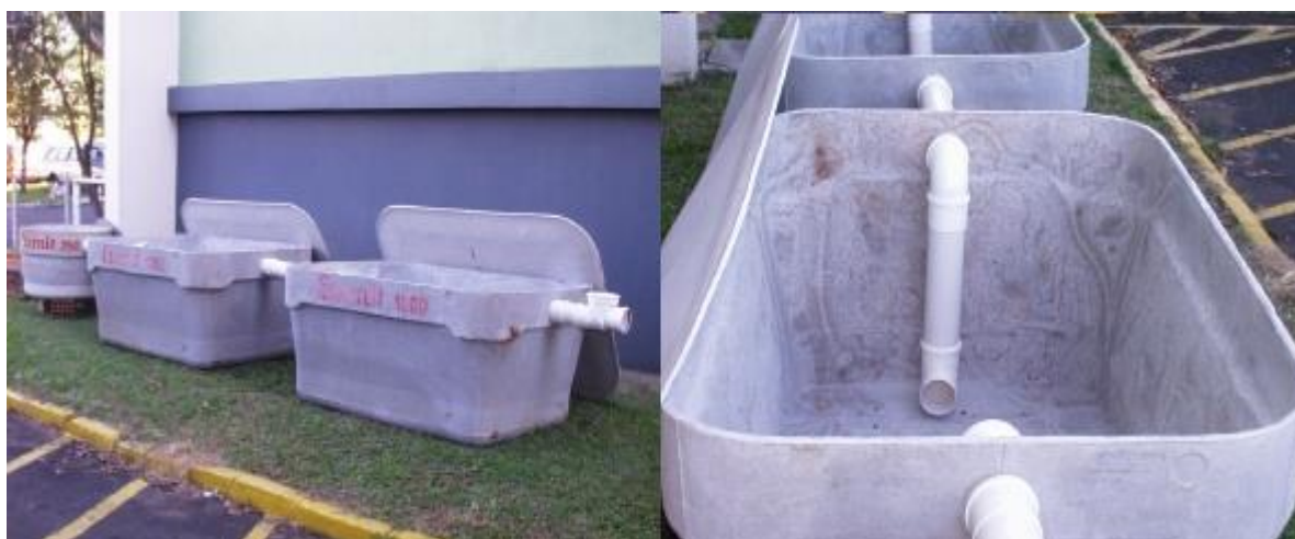
Figura 27: Biodigestor montado: vista lateral e vista superior. Fonte: Embrapa, 2010
